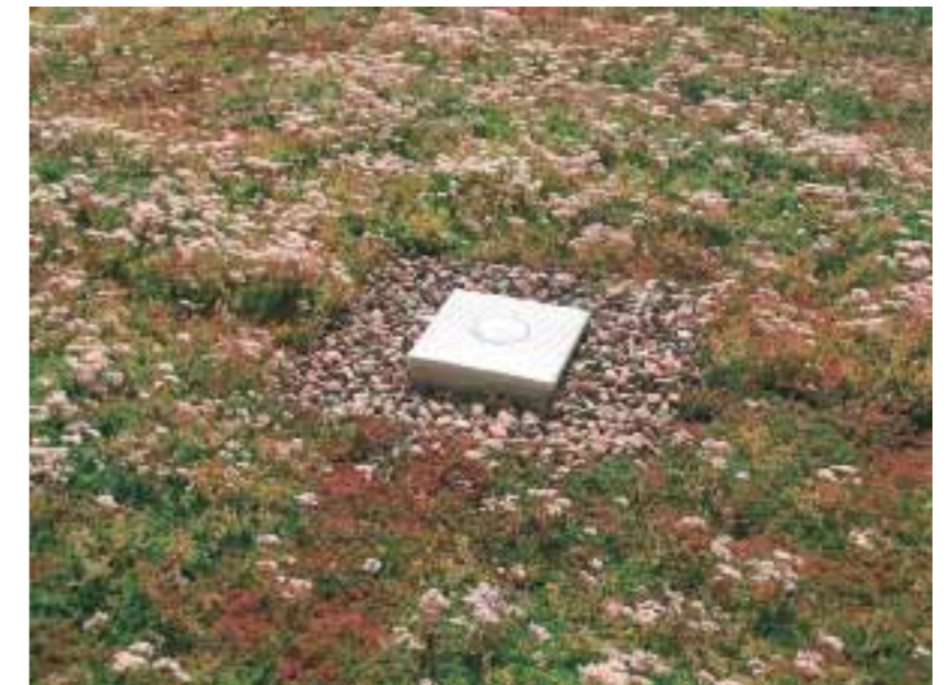
Ein Entwässerungskontrollschacht auf einem extensiv begrünten Flachdach.
