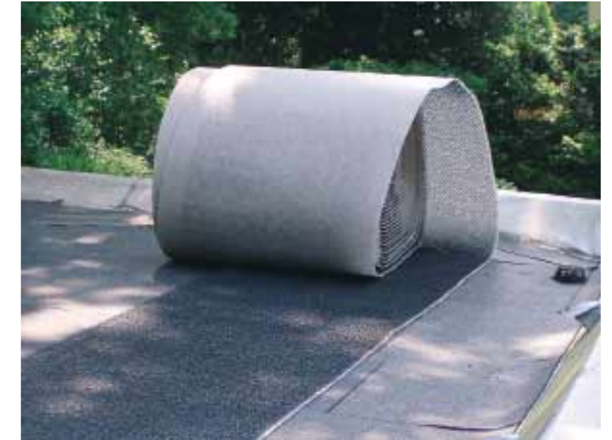
Je nach bautechnischer Ausgangslage müssen unterschiedliche Materialschichten auf dem Dach ausgebracht werden. Hier wird auf Gummischutzmatten die Drän- und Bewässerungsschicht verlegt.
