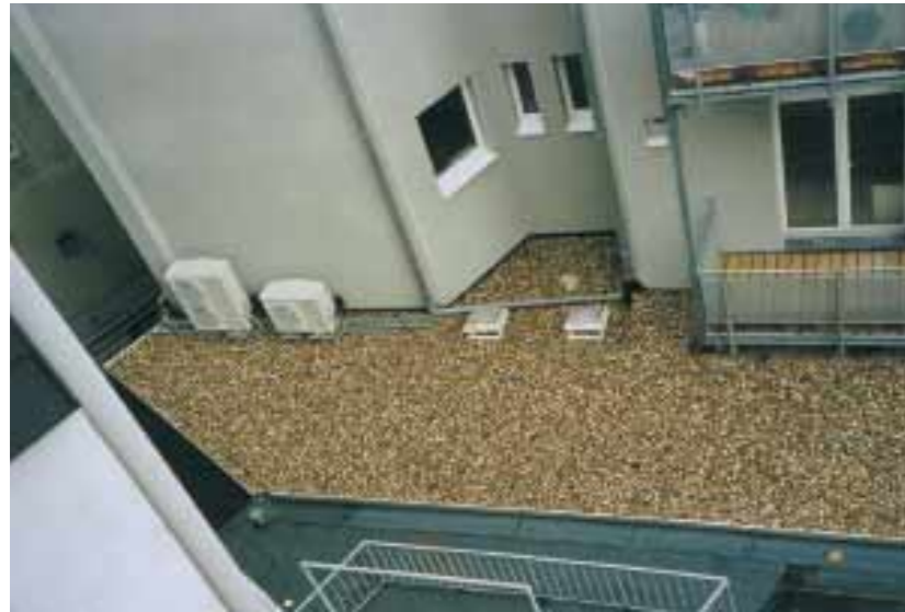
Dieses Kiesdach könnte eine Grünfläche sein.
