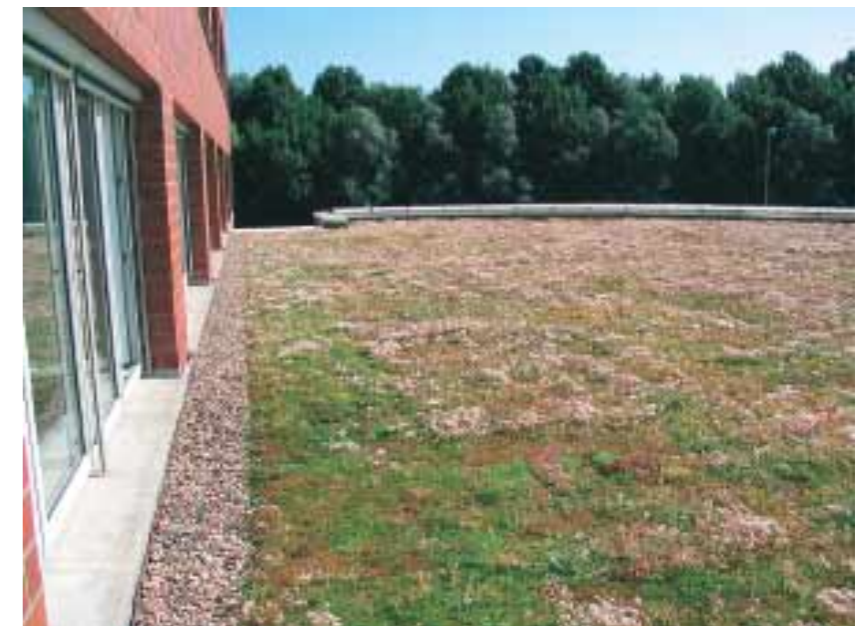
Ein Kiesstreifen am Bürogebäude der Bremer Lagerhaus Gesellschaft im Neustädter Hafen trägt zum Brandschutz bei.
